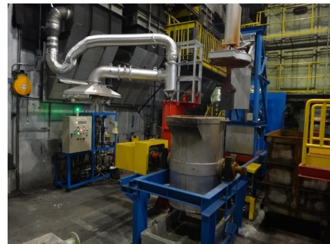
不純物金属（マンガン等）除去装置
